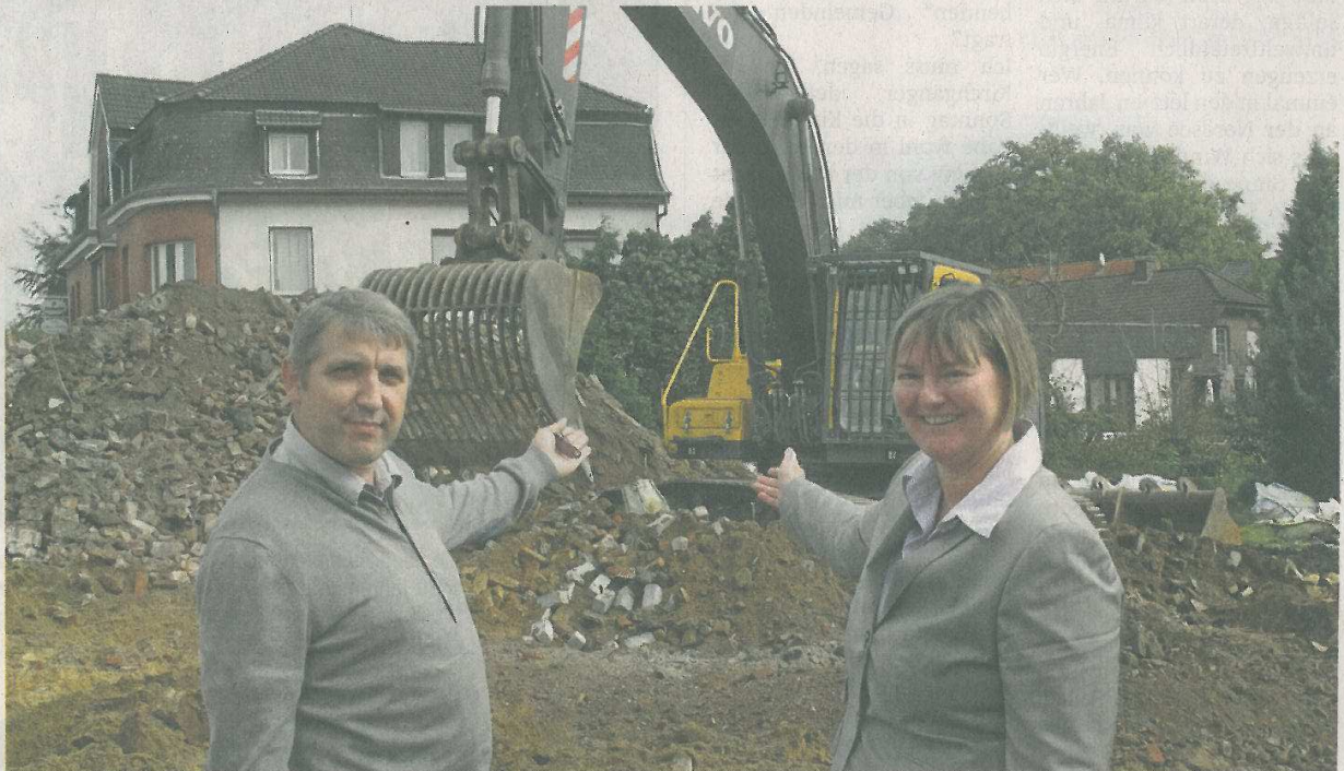
Der erste Schritt – der Abriss des Hövelmann-Hauses – ist getan. Wilfried Kersting und Ursula Eskes wollen im Sommer 2012 an dieser Stelle ein Senioren-Pflegeheim eröffnen.
